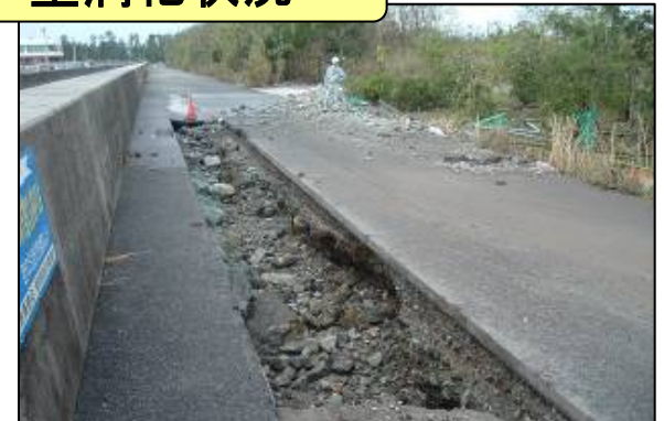
鋼矢板腐食孔からの吸い出しによる陥没被害
