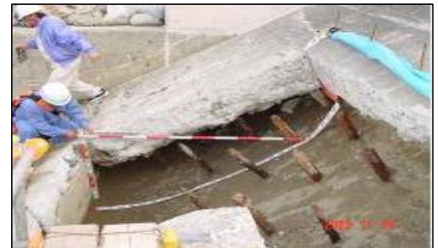
空洞化によって壊滅的な被害のおそれ
