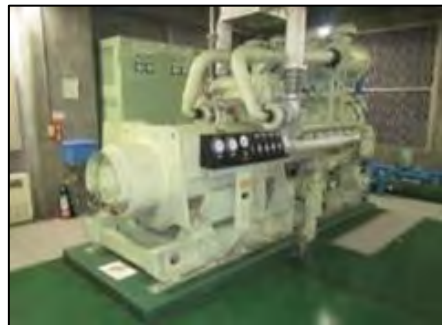
非常用発電機（イメージ）
