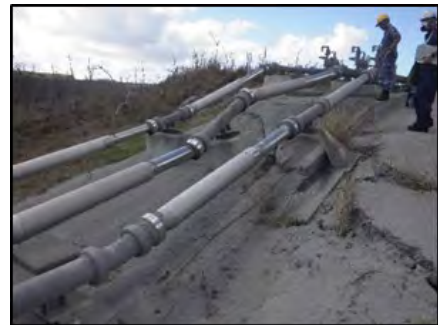
硫黄島のパイプライン破損状況
