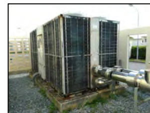
【老朽化した空調設備】
