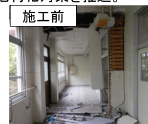
＜老朽化による天井・壁の落下＞
