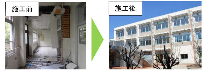
＜老朽化による天井・壁の落下＞ 学校施設の老朽化対策
