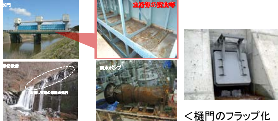
＜施設の老朽化例＞ 河川管理施設等の老朽化対策
