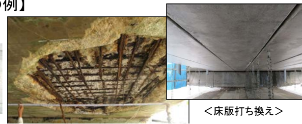
＜床版鉄筋露出＞ 道路施設の老朽化対策
