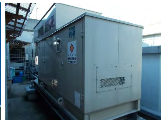
(非常用自家発電装置)
