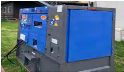
（非常用自家発電設備）
