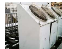
電気ヒートポンプ
