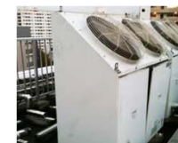
電気ヒートポンプ
