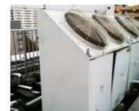
電気ヒートポンプ
