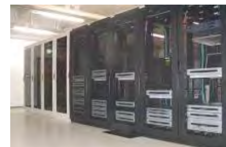
S-iDC (データセンター)
