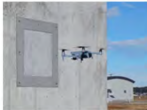
ドローンによる損傷把握
