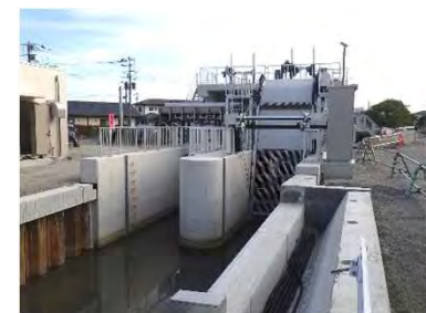
下水道施設(雨水ポンプ場)
