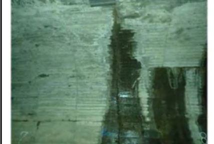
損傷状況(うき・漏水)
