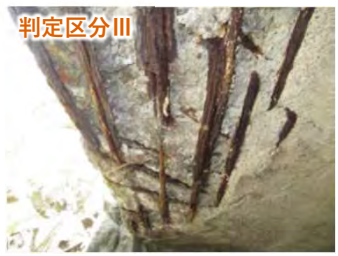
橋の裏側の鉄筋露出
