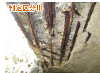
橋の裏側の鉄筋露出
