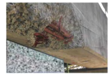
損傷状況(鉄筋露出)
