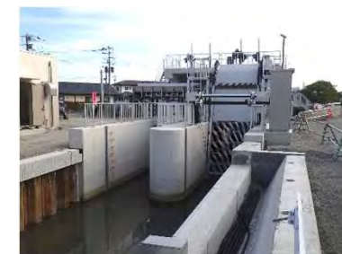
下水道施設(雨水ポンプ場)
