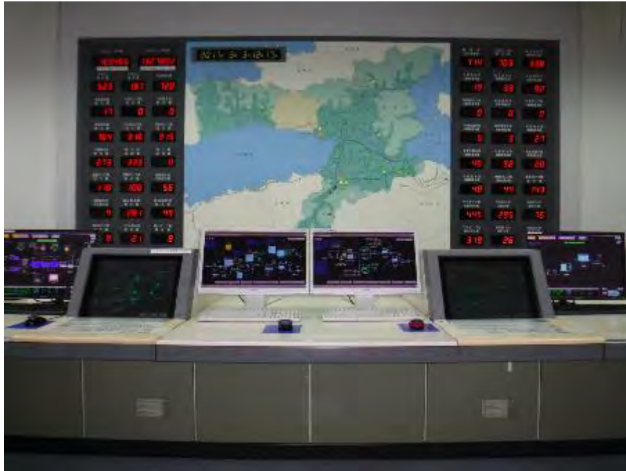
大型制御装置(DCS)の表示装置
