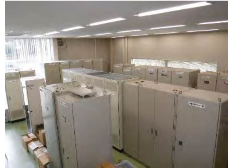
大型制御装置(DCS)の本体と施設の通信装置
