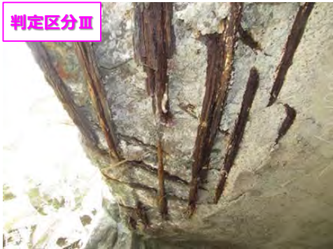
床版鉄筋露出 ※床版:橋の裏側
