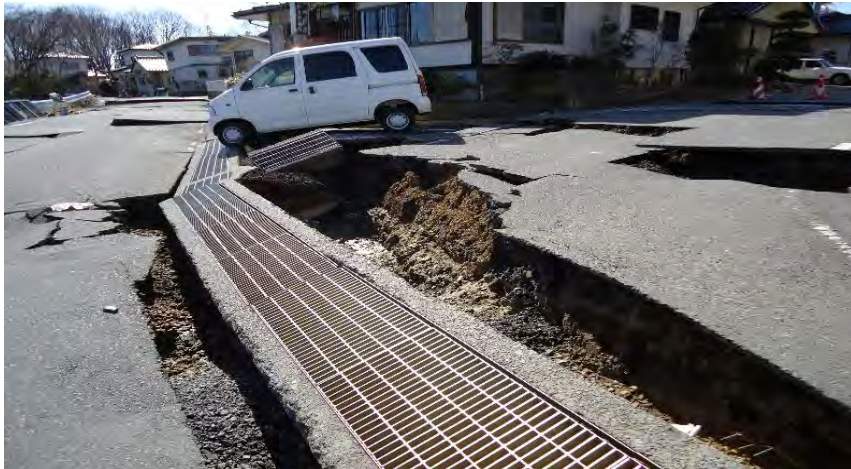
地震により崩落した道路
