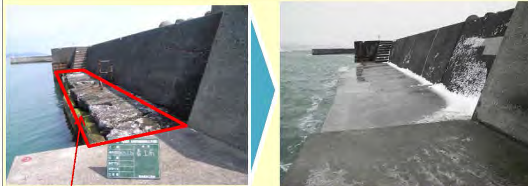
老朽化した防波堤
