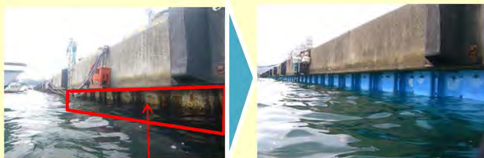
老朽化した岸壁
