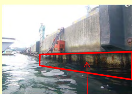
老朽化した岸壁
