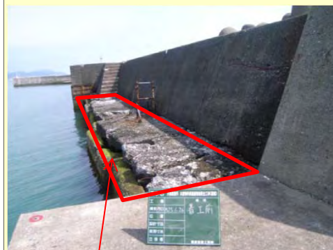
老朽化した防波堤
