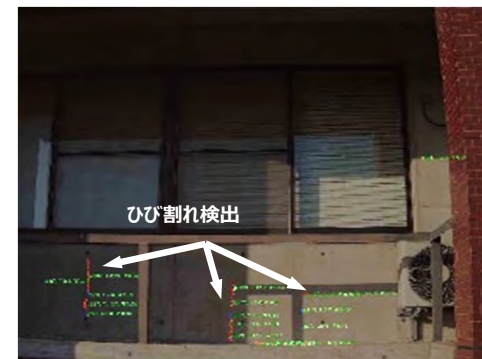
A Iによる判別結果の一例 (4 Kカメラ画像を用いたひび割れ検出)
