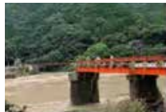
熊本県道深水橋 橋梁流失 令和2年7月豪雨 (4ヶ月以上の通行止め)
