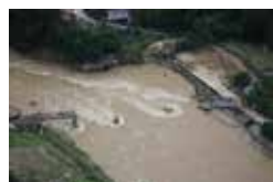
JR芸備線 第1三篠川橋梁流失 平成30年7月豪雨 (1年3ヶ月の運休)
