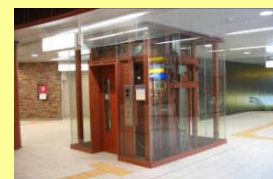
エレベーター
