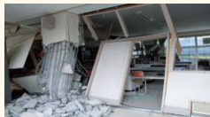
【地震による大きな被害】
