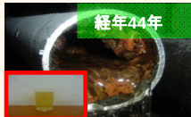
【給水設備の劣化】
