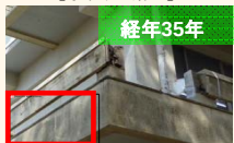
【手すりの落下】
