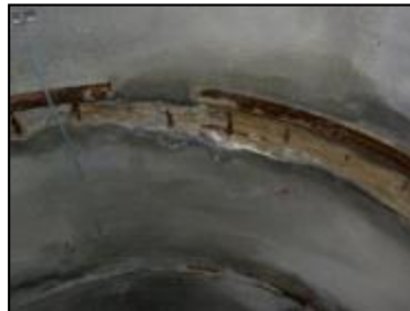
覆工コンクリートの剥落
